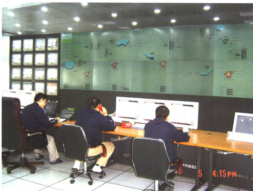
引黄工程自动控制调度大厅
