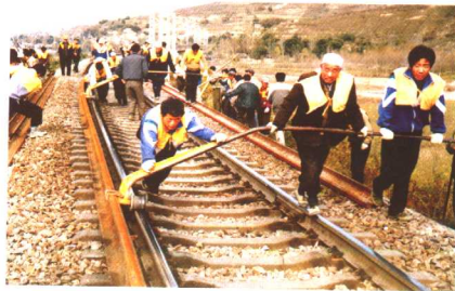
全力整治线路病害
