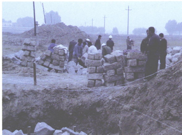
1-1-4 基坑附近毛石堆放不规范、不牢固，易倾塌
