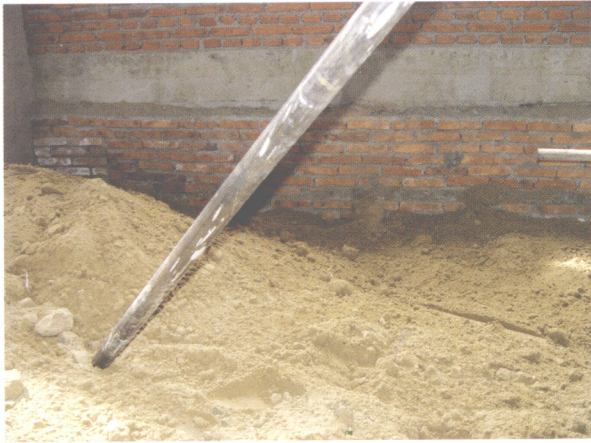
1-1-7 回填土过厚, 未采取分层夯实措施
