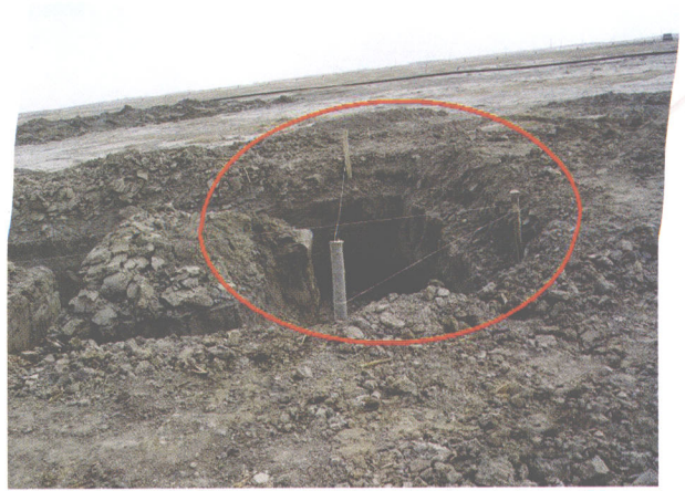
1-1-11 基槽放线不合格
