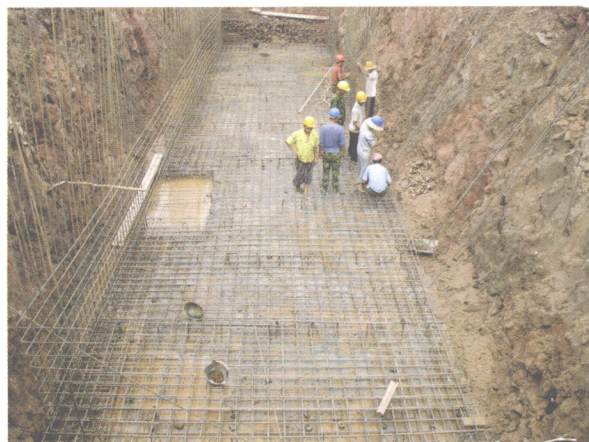
1-1-5 基坑内未设排水沟,造成钢筋、垫层上污泥污染
