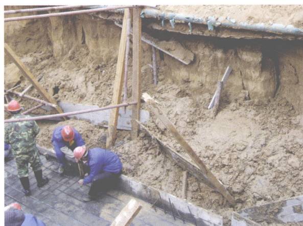
1-1-3 在塌方段未采取井点降水及有力的加固措施
