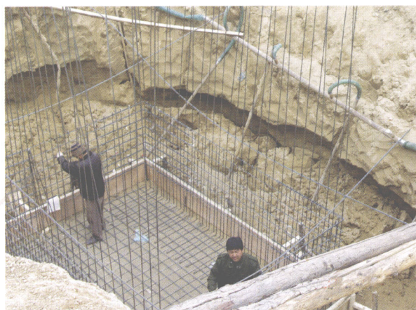
1-1-2 深开槽井点降水但加固措施不到位,塌方严重
