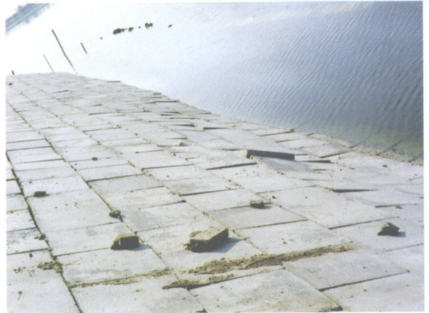
1-1-10 护坡未夯实, 局部塌陷
