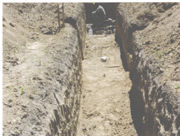
1-1-6 基槽作业面不足
