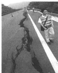
图 1-4 四川某高速公路的路堤边坡破坏
