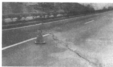
图 2-1 贵新路出现的路面塌陷情况
