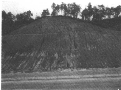
图 1-1 边坡表层水土流失
