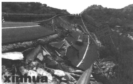
图 1-3 福建某高速公路路堤破坏
