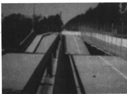
桥基沉降引起桥面断裂
