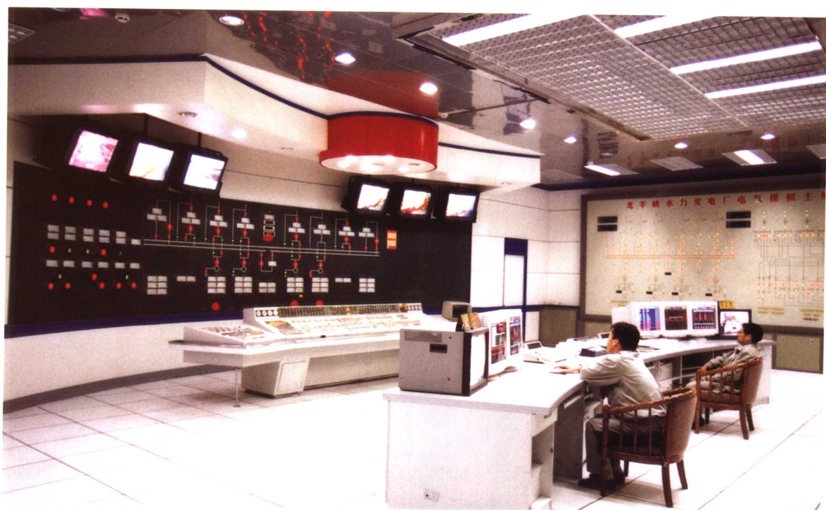
龙羊峡水电站中央控制室
