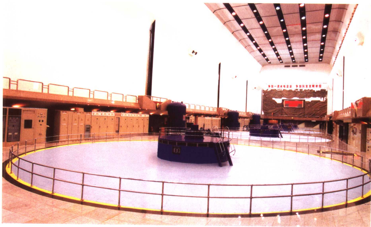
龙羊峡水电站水轮发电机组
