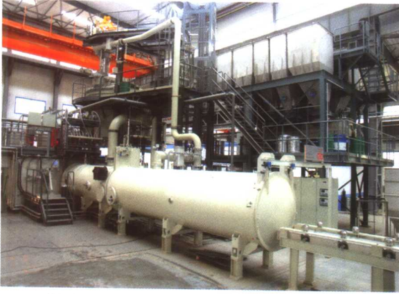
具有世界一流水平的2400kW EB炉
