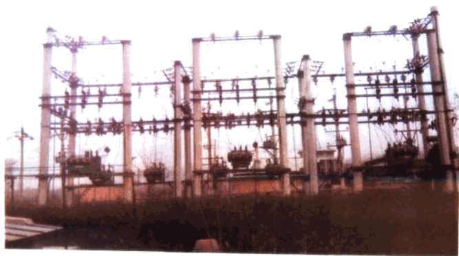
陕县电业局 10 千伏开关站
