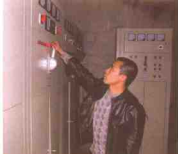
上吐京煤矿双回路供电系统配电柜
