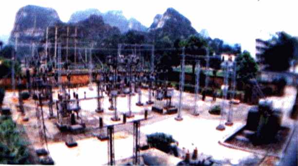
俯视老街变 电站
