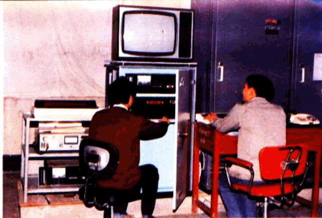
电力调度 运动装置
