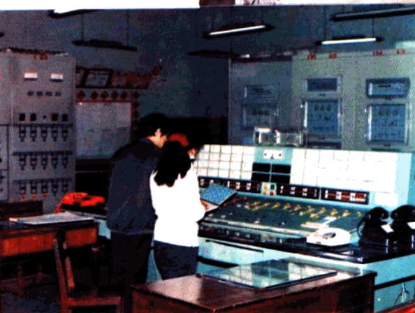
六圩 220 千伏 枢纽变电站控制室
