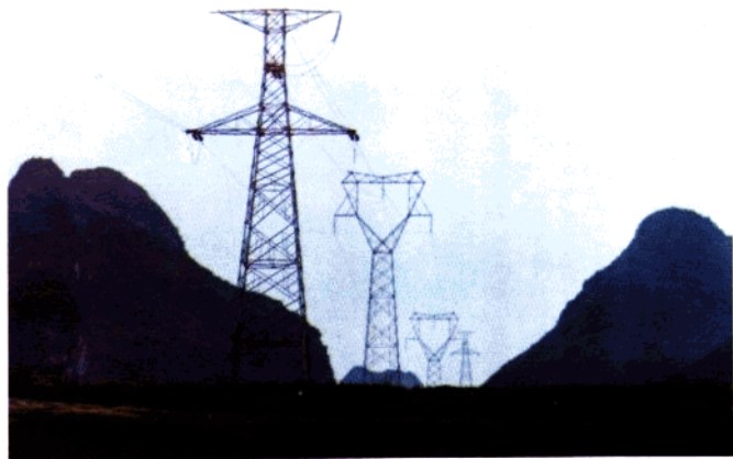
合山至金城江220千伏输电线路塔群
