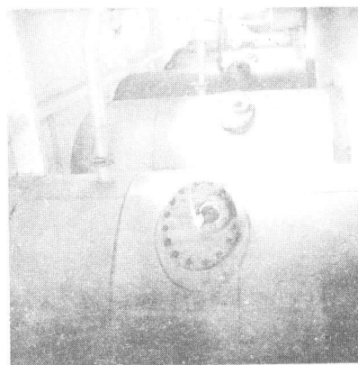
硝酸吸收塔 (衢州化工厂) \phi 2000 , H 12000 毫米。硬聚氯乙烯 介质: 50% 硝酸
