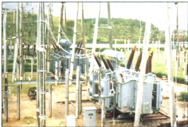
1989年9月,龙岩地区最大的220千伏龙岩曹溪变电站(总容量12万千伏安)建成送电。
