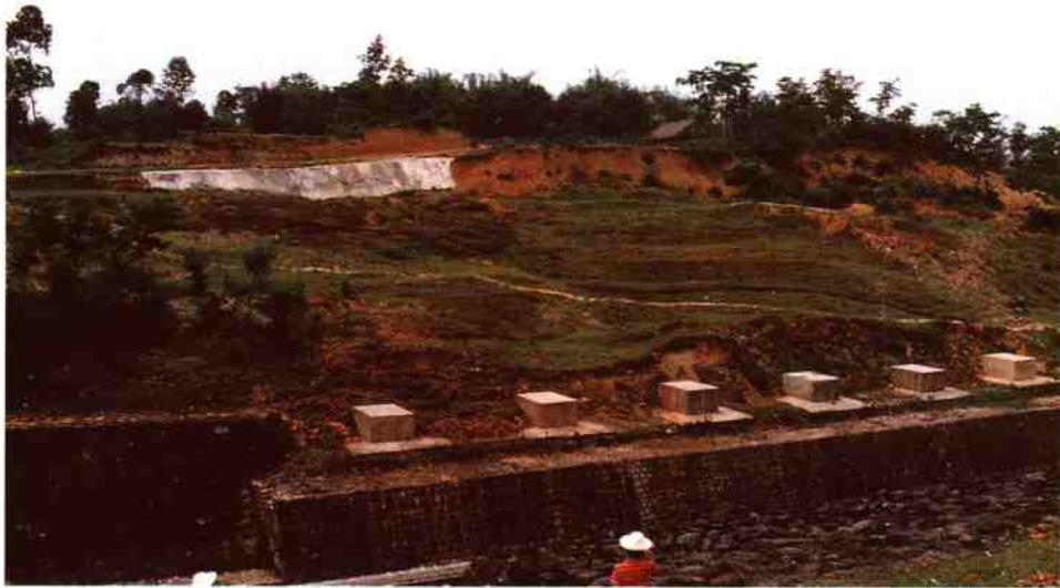
照片 2—1 成昆线皂角树 1# 成都黏土滑坡 (K46+440~+520) 全貌
