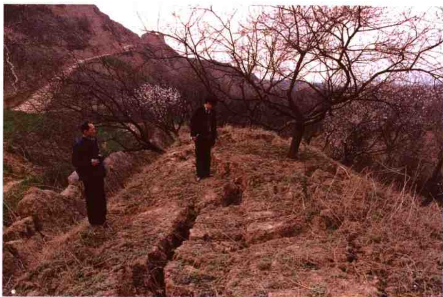
照片 1—6 鼓胀裂缝
