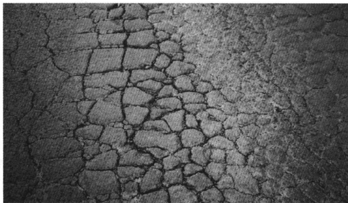
图1-4 路面典型的唧浆破坏
