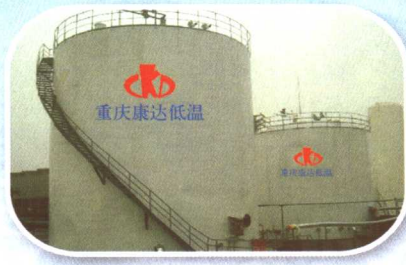
低温液体(包括 LNG)大、中型贮槽及配套汽化设备、管道工程
