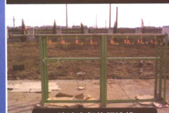
法液空气体汇流排
