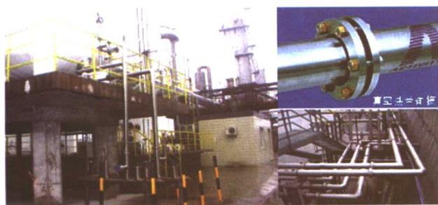
高真空多层绝热低温液体输送管道
