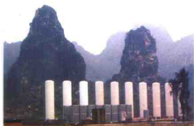
● 1000M 3 LNG 贮存汽化站
