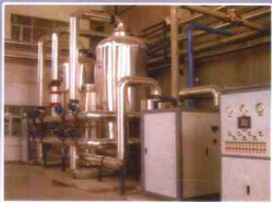
KDN-1600/70Y 型高纯氮设备 冷机组和纯化器系统及机旁仪控柜
