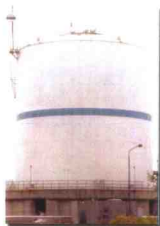
2000m 3 低温液体贮槽
