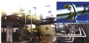
高真空多层绝热低温液体输送管道
