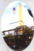
500m 3 低温液体贮槽
