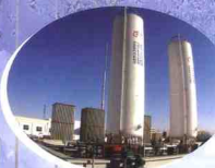
LNG应用工程
