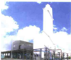
↑ 内蒙古通辽梅花生物科技有限公司 10000m³/h空分设备
