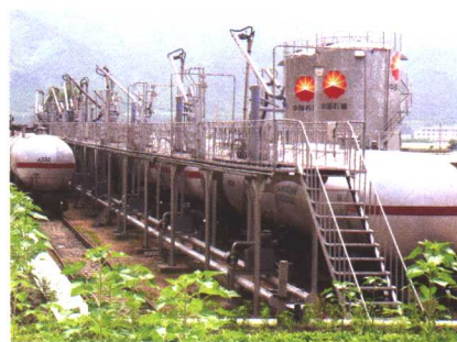
◆忙碌的油库卸油区
