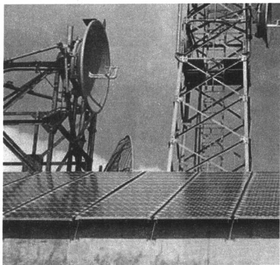
图 2-7 微波通讯中继站光伏电源
