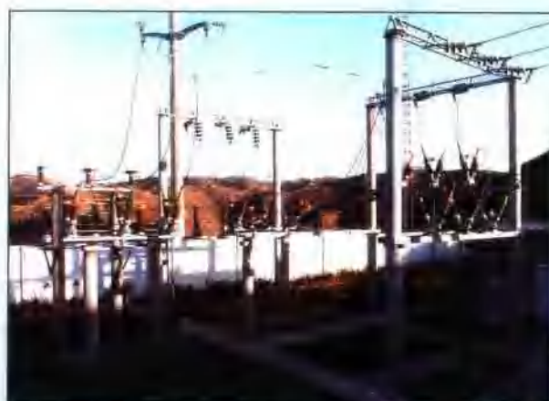
南岸引水口工程35KV (3150KVA) 专用变电站, 图示变电站高压端
