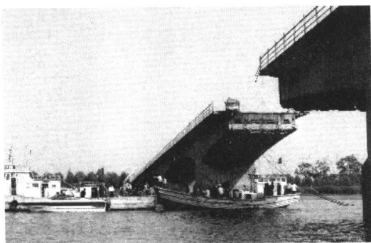
图 1-2 超限超载运输引起的桥梁垮塌事故
