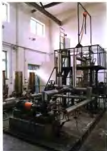
核电厂蒸汽发生器化学清洗试验回路
