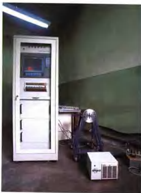
核电厂燃料元件破损监测系统
