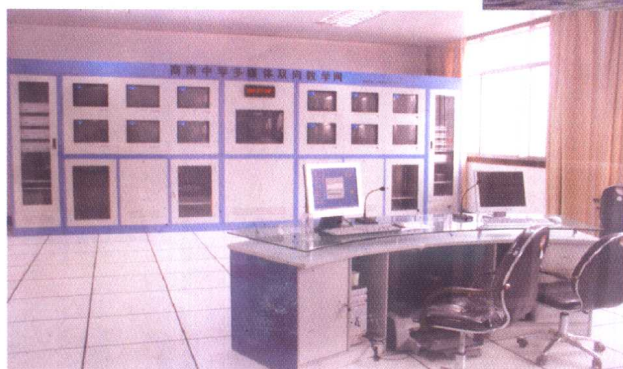
◀ 商南高级中学校园网中心机房。
