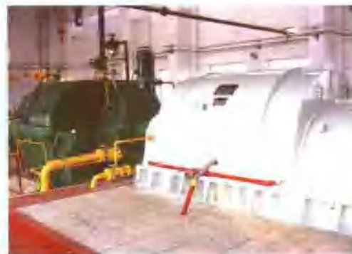
宣钢，包钢高炉煤气余压发电工程
