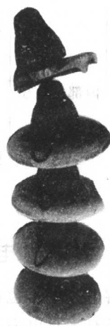
图 1-1 某 66kV 架空电力线路雷击塔顶，引起过电压反击，瓷瓶闪络，第一片被击碎，第三片掉渣，沿面有放电痕迹
