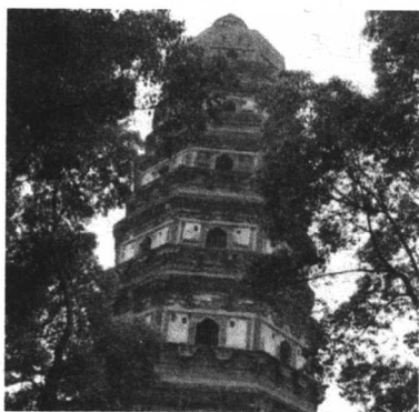
图 1-2 苏州虎丘塔因地基不均匀变形倾斜
