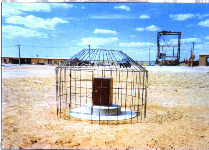
由地面造孔至隧洞顶部的多点位移计，用于测量开挖过程中的变形，指导安全施工
