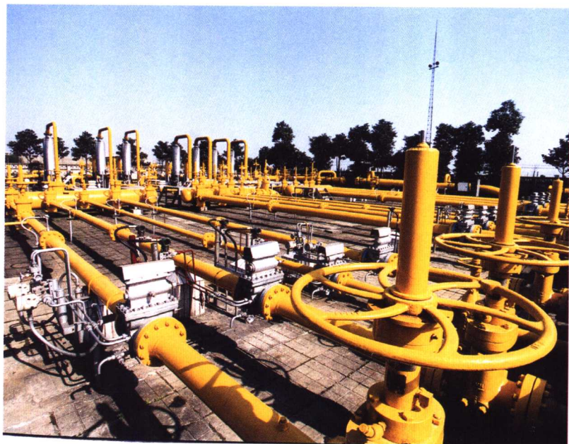
天然气处理站
