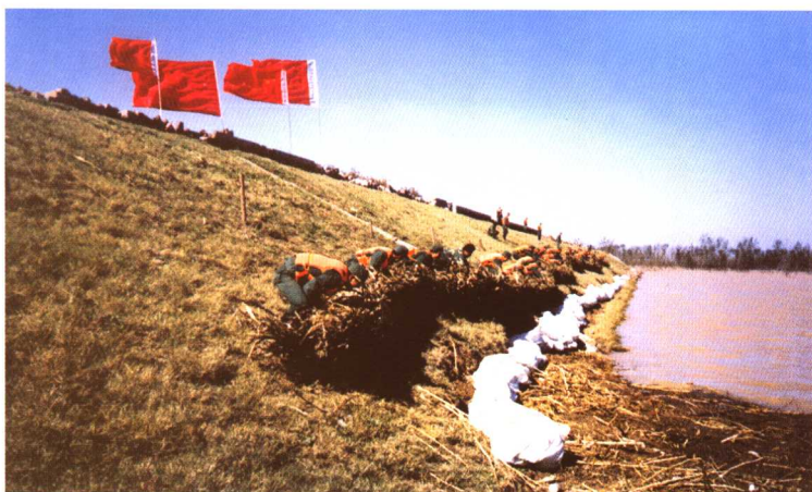
◀ 2003年10月，东明黄河堤防工程出现风浪险情，武警官兵正在抛枕抢护
