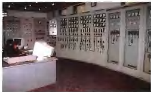
设备先进的中心控制室
