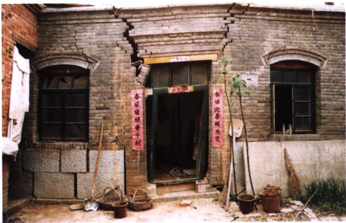
II-2 采空塌陷造成房屋开裂
