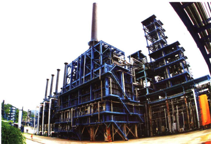
长岭石化公司组合床催化重整装置
