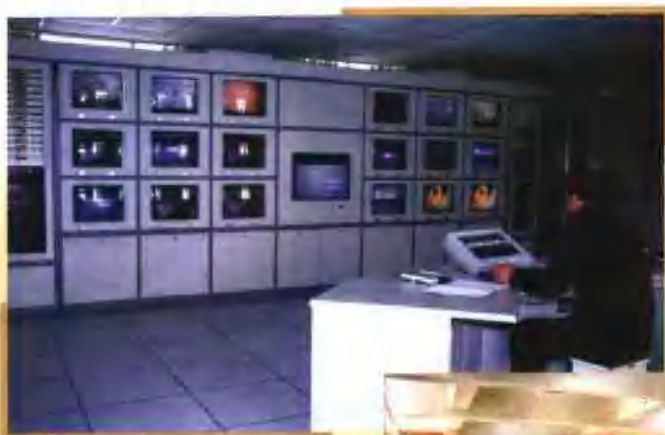
【多媒体网络总控室】
