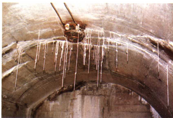
照片 18 乌江渡大坝灌浆廊道中的鹅管
