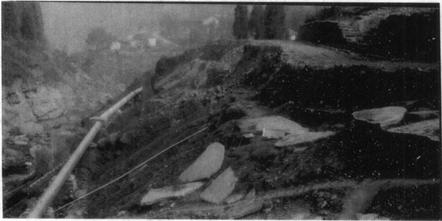
图 1-9 坡脚被水冲刷后导致的路堤滑坡
