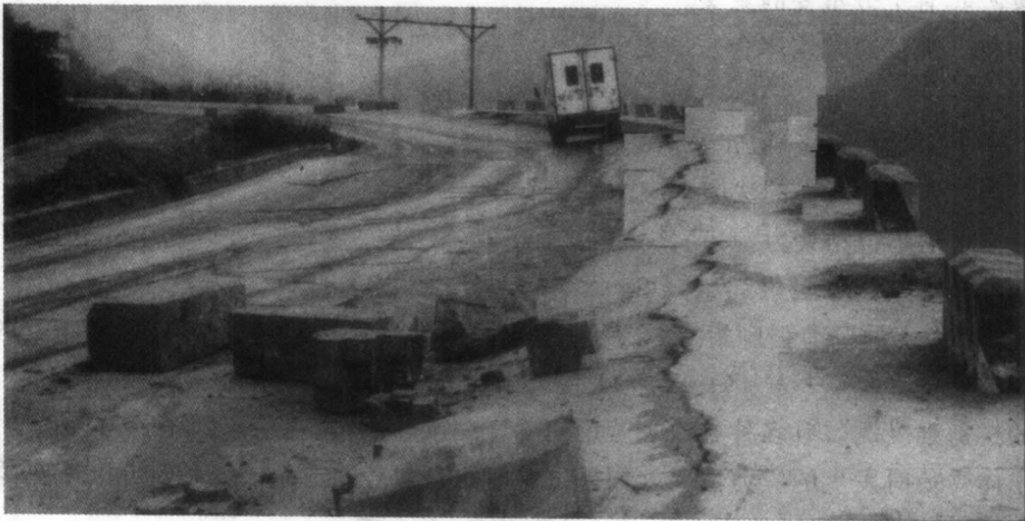
图 1-7 由于路堤沉降导致路面破坏
