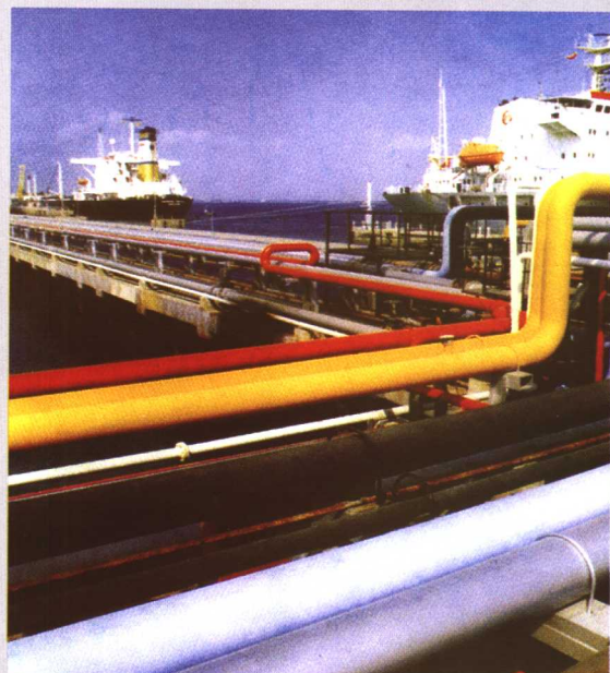
60年代建成的华南石油进出口贸易大港——湛江港油码头。
