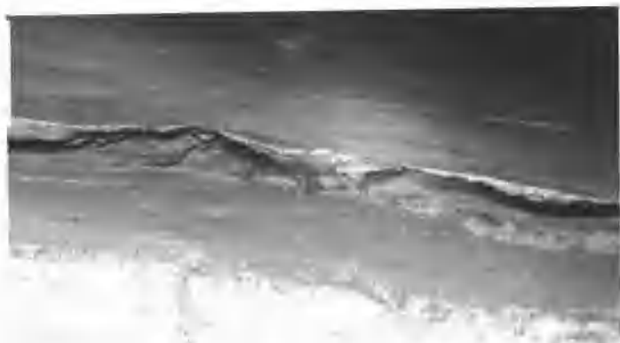
图 1.2 运营隧道衬砌开裂病害
