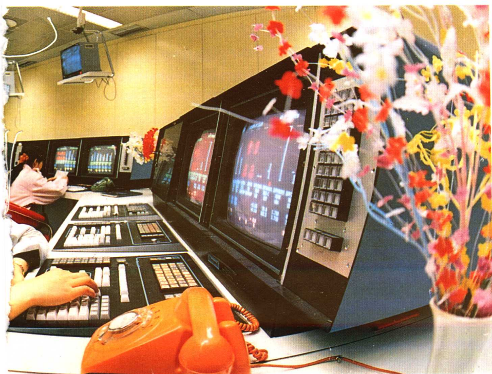
涤纶生产厂中央控制室
