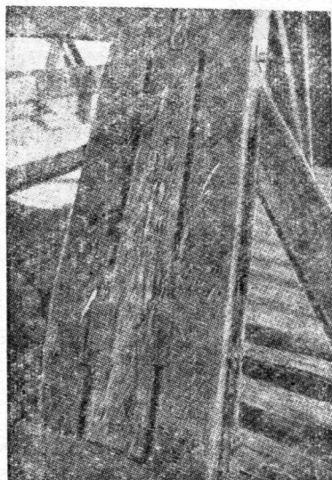
圖10 豪氏桁架支座斜桿嚴重腐朽的情況
