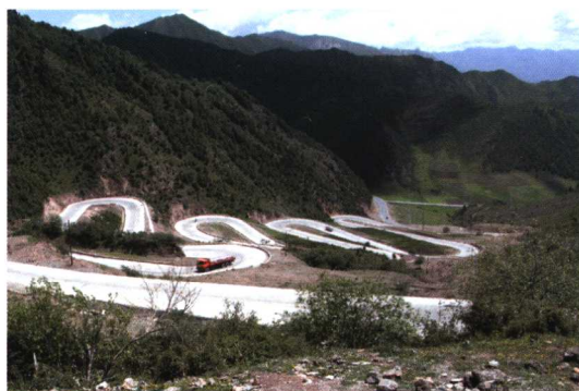
疏排水和支挡相结合治理成功的 青海互助北山 K37~K39 段公路病害
