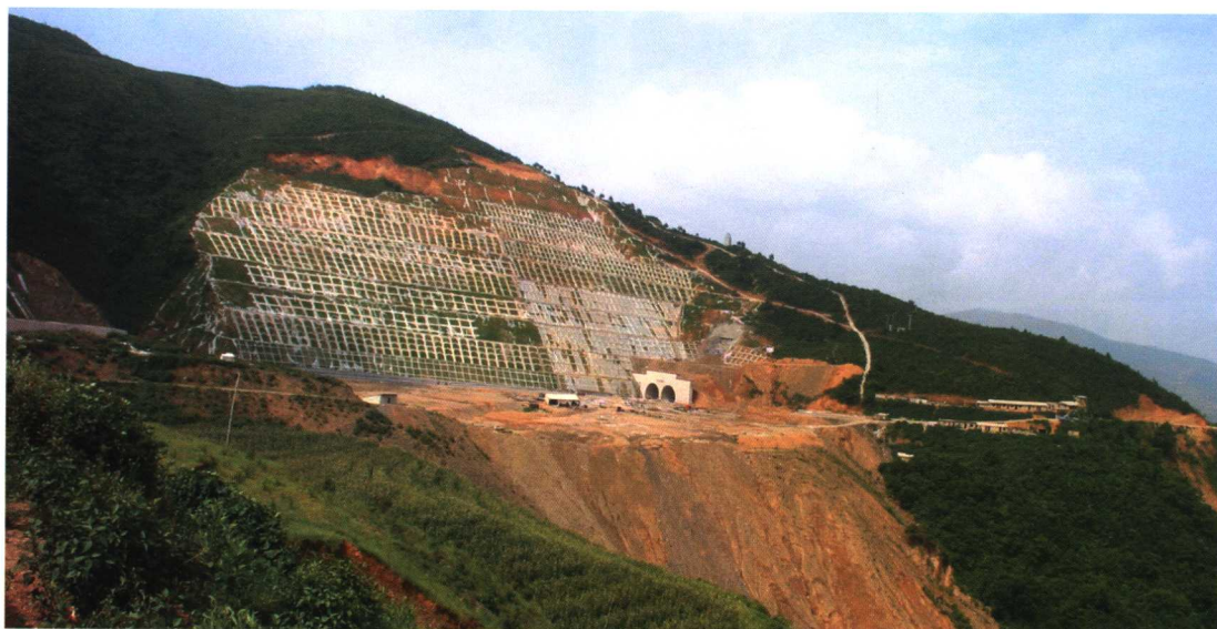
元磨高速公路三公箐隧道进口端坍塌性滑坡
