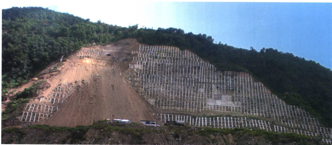
元磨高速公路K235+160~+600大型崩塌
