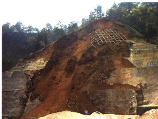
变形破坏后的贵州三凯高速公路 南约沟隧道进口段高边坡
