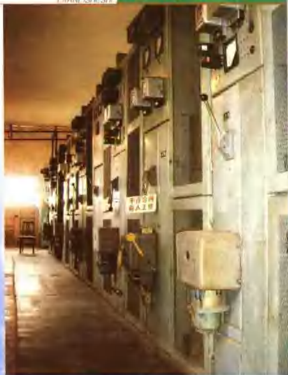
■ 输变电站主控室。
