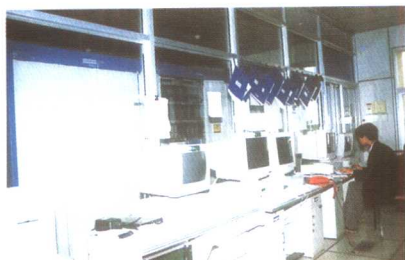
电信局程控机房
