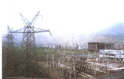
城关110千伏变电站
