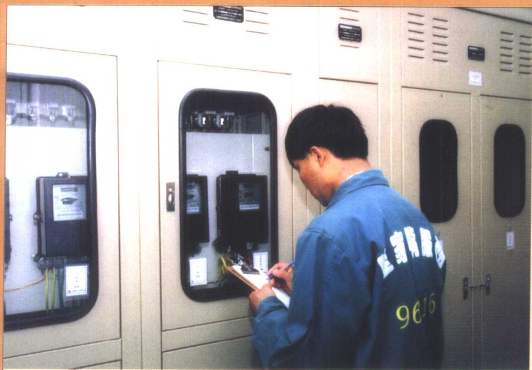
◆电网跳闸后,维保人员全面检索,以防不测。
