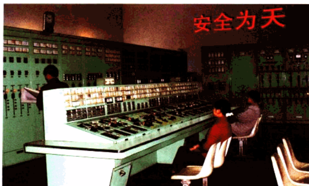
发电厂主控室一角
