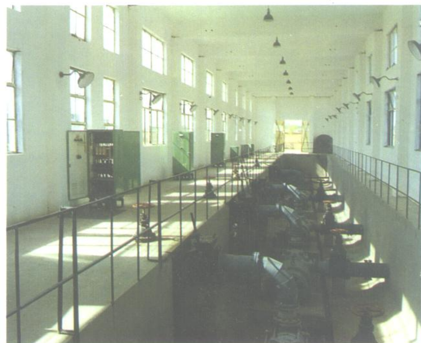
供水总站泵房
