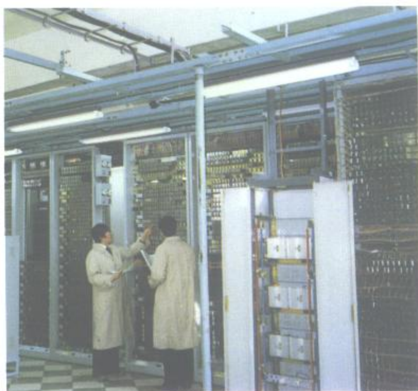
程控交换机房
