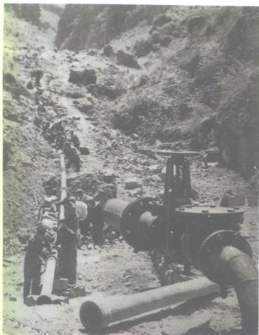
乱石泉送水工程
