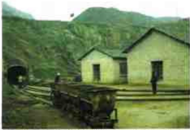
江西朝阳磷矿正在建设中的 10 万吨采选配套项目， 平铜采矿工程井口一角
