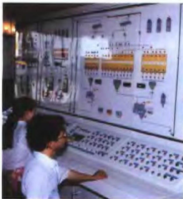
高安縣陶料廠中央控制室
