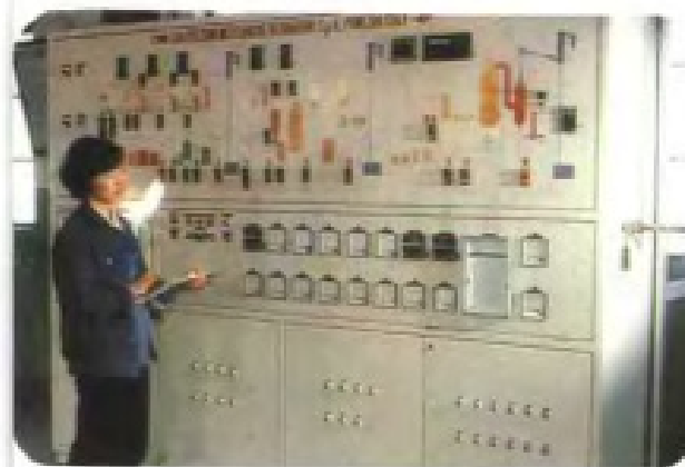
樟樹糧油公司精煉油控制操作屏
