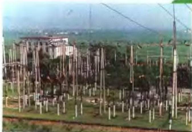
赣西供电局 220 千伏珠璣枢纽变电站
