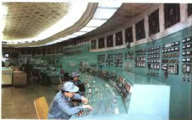
九江火力发电厂主控制室
