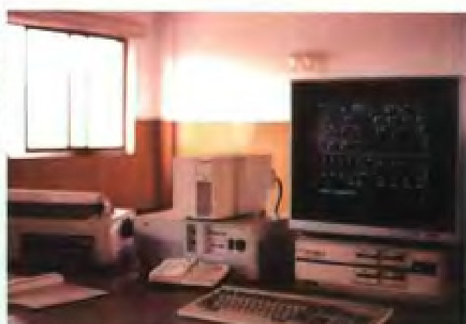
(邮伯泉摄) 彭泽县供电局电力调度运动装置
