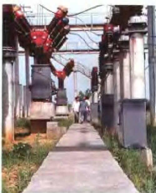
萍乡供电局工人正在巡视跑马坪 220 千伏 变电站设备
