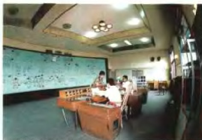
赣东北供电局地区调度控制室
