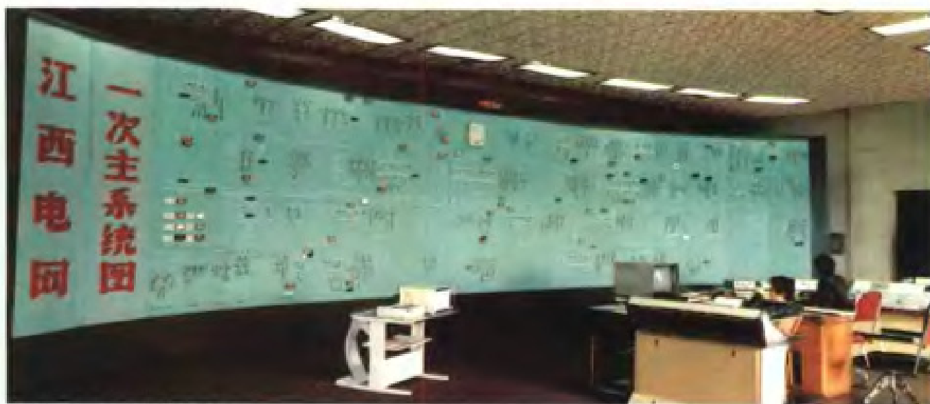
江西省电力中心调度所主控制室
