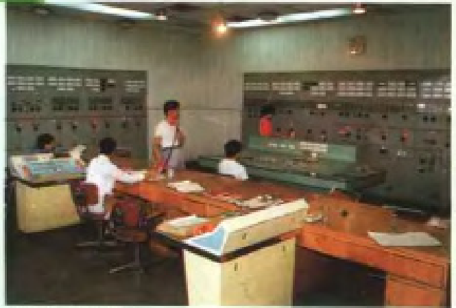
南昌电厂主控制室
