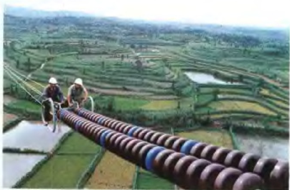
江西省送变电建设公司工人正在葛洲坝——上海 500 千伏直流线路上施工,该工程获 国家银质奖
