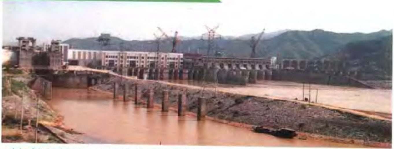
正在建设中的国家重点工程——万安水电站全景,装机4×10万千瓦
