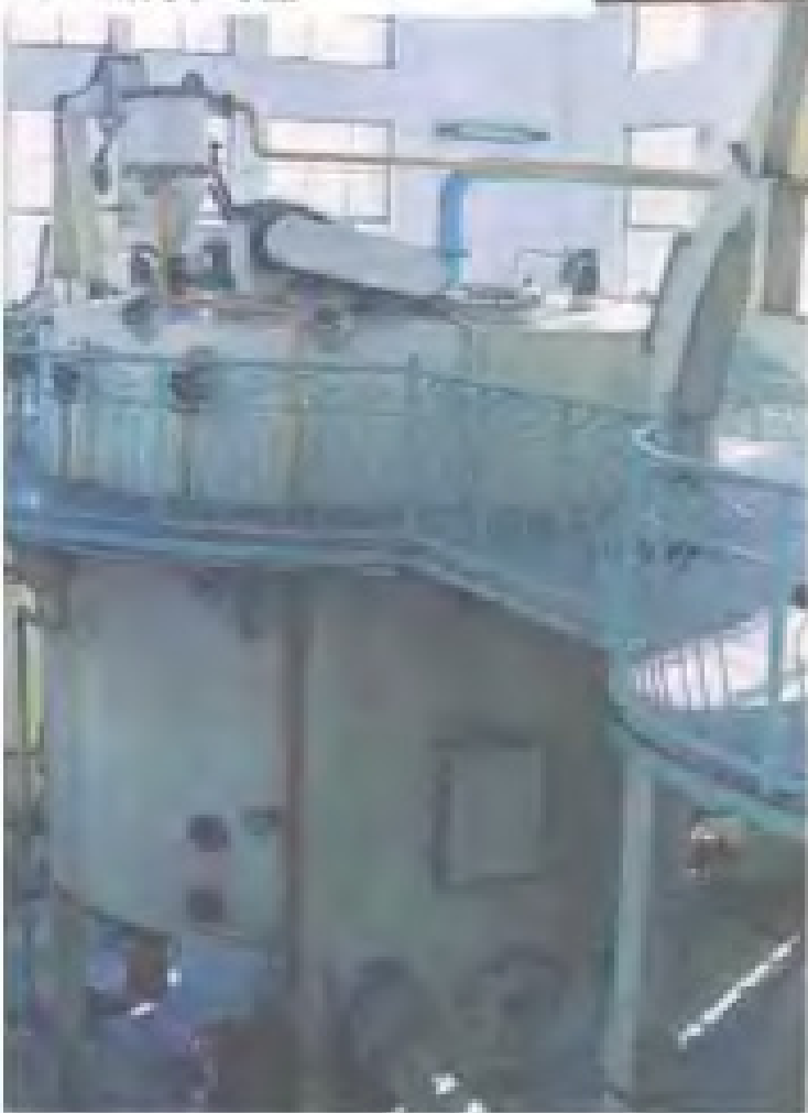
23. 新沂县油脂化工厂浸出间油脂浸出器
