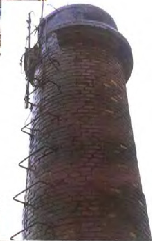
太仓沙溪镇酿造厂砖烟囱出现斜裂缝。
