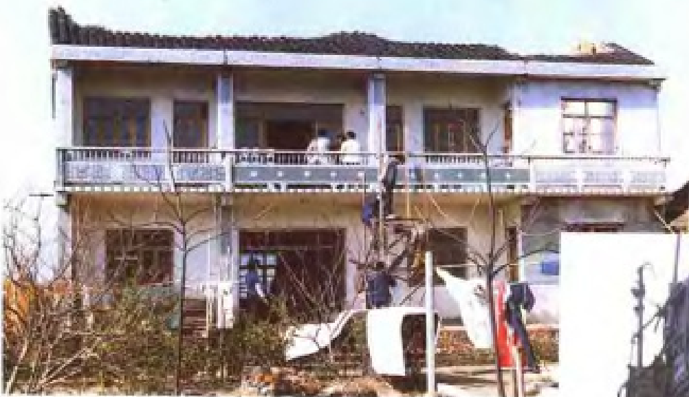
太仓直塘曾湾村16组高明龙家屋顶坍塌。
