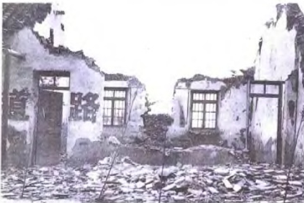
溧阳大溪黄山小学房倒屋塌。
