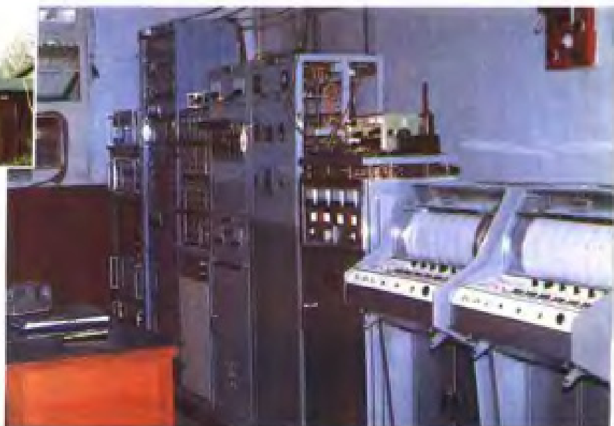
南京遥测地震台网南京记录中心机房。
